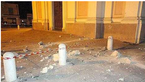
Calcinacci dal campanile, dopo la prima scossa
